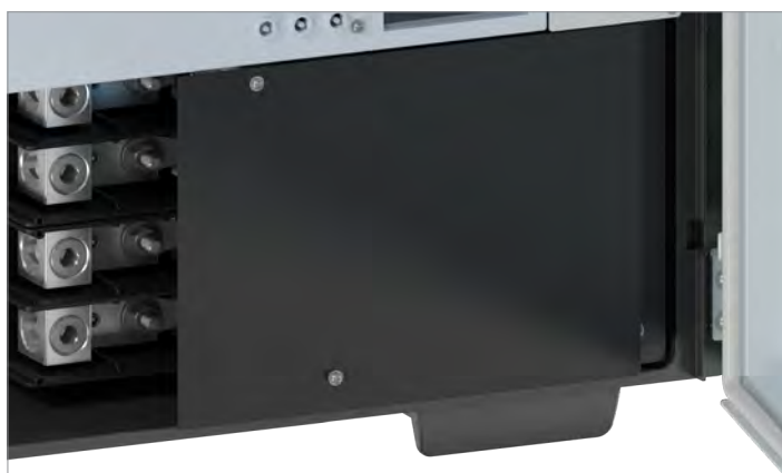
Position der AC-Überspannungsableiter
