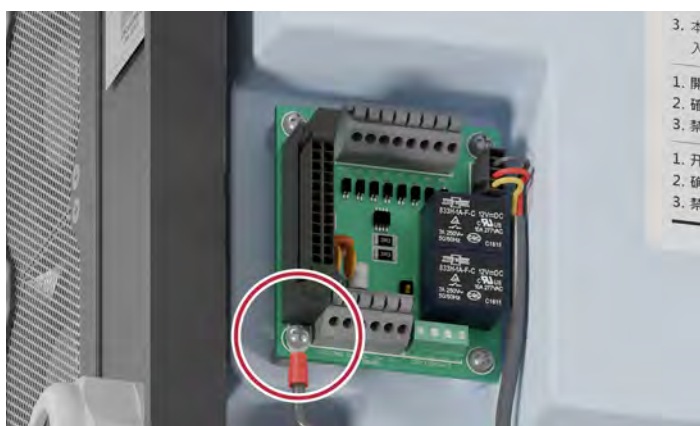
Erdung des RS485-Kabels
