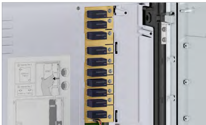
Abb. 4.12: Ansicht der DC-Überspannungsableiter bei entfernter Abdeckung
