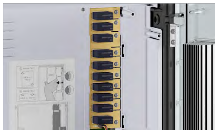
Abb. 4.14: Ansicht der DC-Überspannungsableiter bei entfernter Abdeckung
