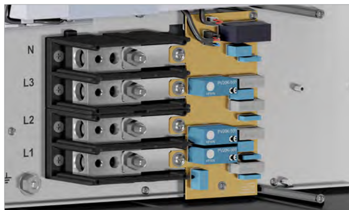
Abb. 4.6: Ansicht der AC-Überspannungsableiter bei entfernter Schutzabdeckung
